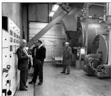
Åbent hus på Auning Fjernvarmeværk. I efteråret 1992 stod et nyt halmfyret anlæg klar med en 3,15 Mwh. kedel til at forsyne omkring 600 husstande i Auning med varme.
